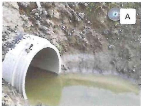
Esgoto sem tratamento.
