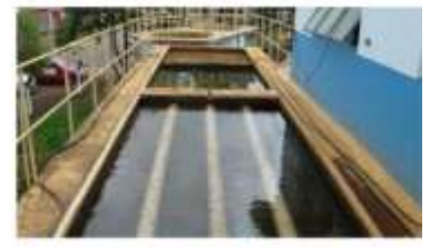
Tanque de tratamento de
