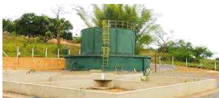
“ETE” Estação de tratamento do esgoto
