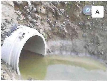
Esgoto sem tratamento.
